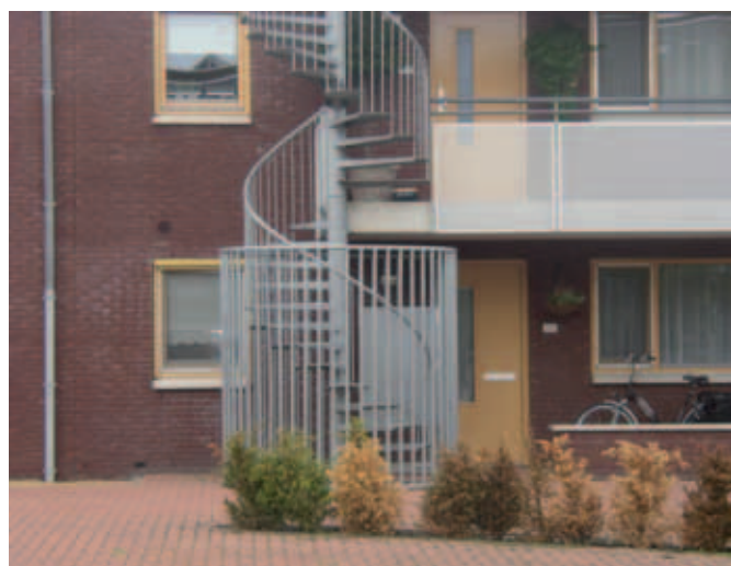
Deze noodtrap is onvoldoende afgeschermd
