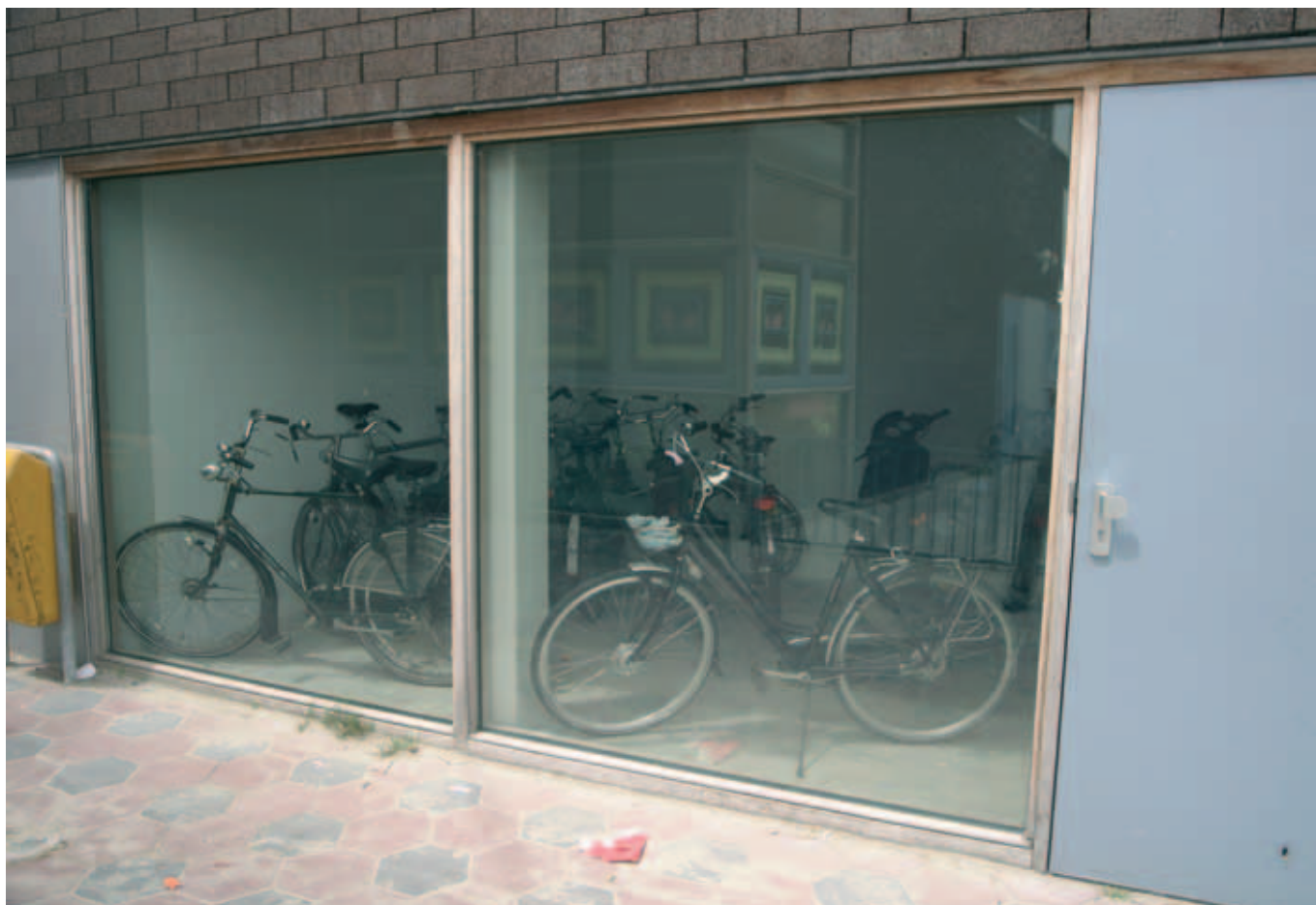
Dit is geen gewenste situatie. Let op: het glas direct naast deze toegangsdeur dient minimaal P4A te zijn en bij voorkeur is er geen zicht op de fietsen/scooters van buitenaf.
