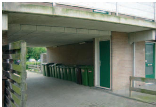
Fout: geen toegangsdeuren onder een onderdoorgang
